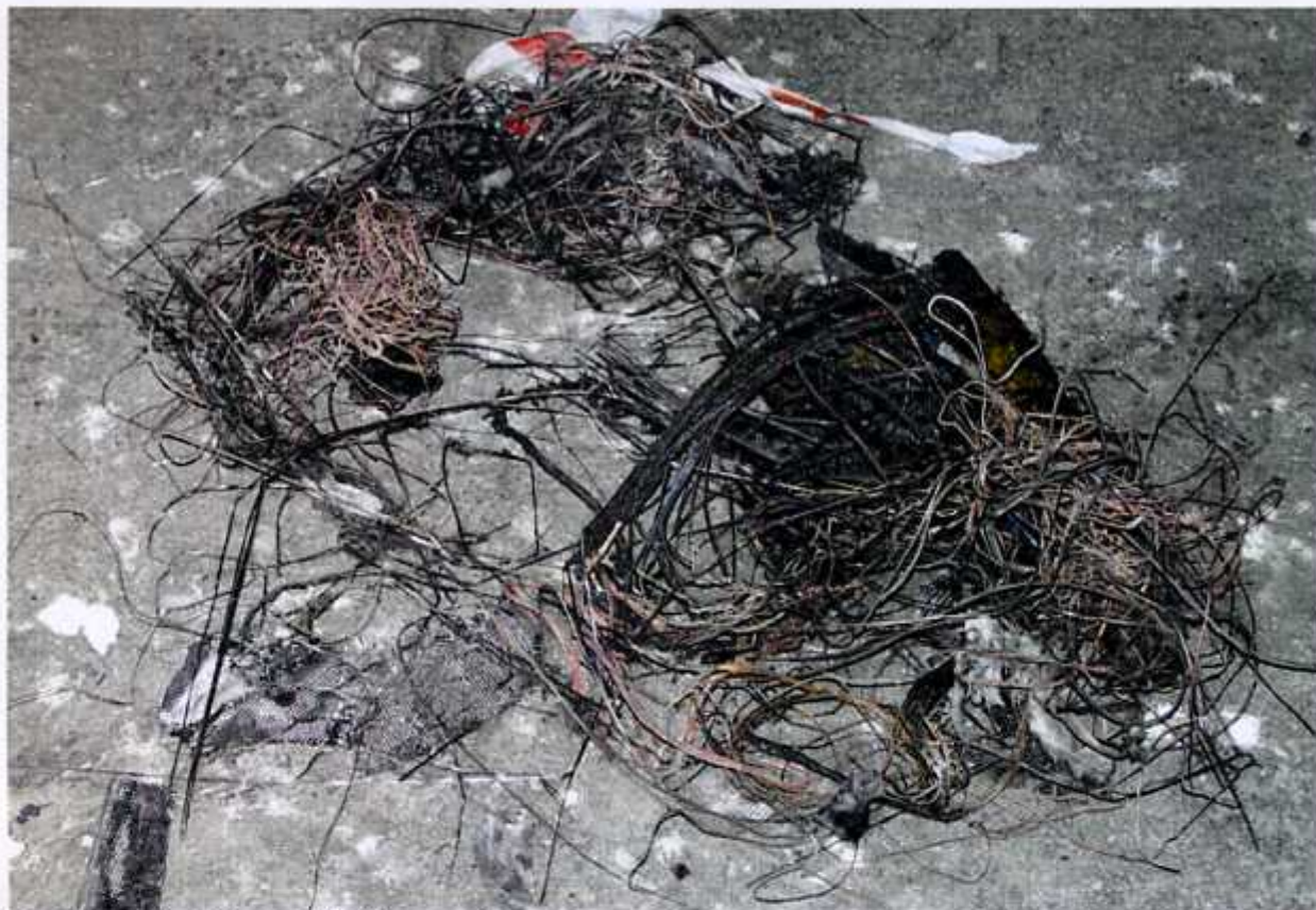
26 – Pozostałości instalacji elektrycznej.
