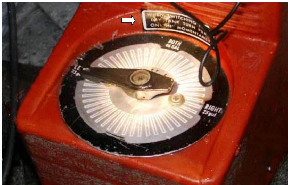
Fot. 14 – Zawór przełączający paliwo w położeniu po awaryjnym lądowaniu; widoczna, oznaczona strzałką, tabliczka: WHEN SWITCHING FROM A DRY TANK, TURN PUMP ON HIGH MOMENTARILY.
